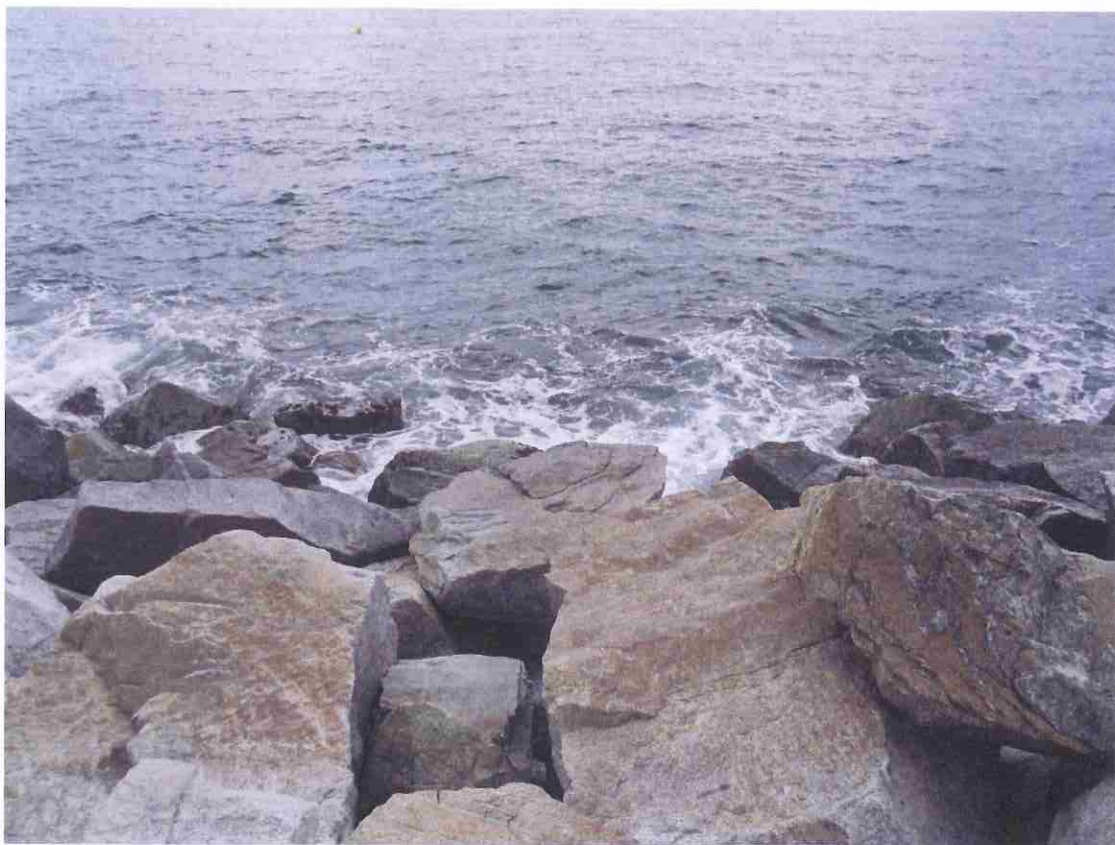
Lado mar del espigón, con pérdida de algunos elementos del manto
